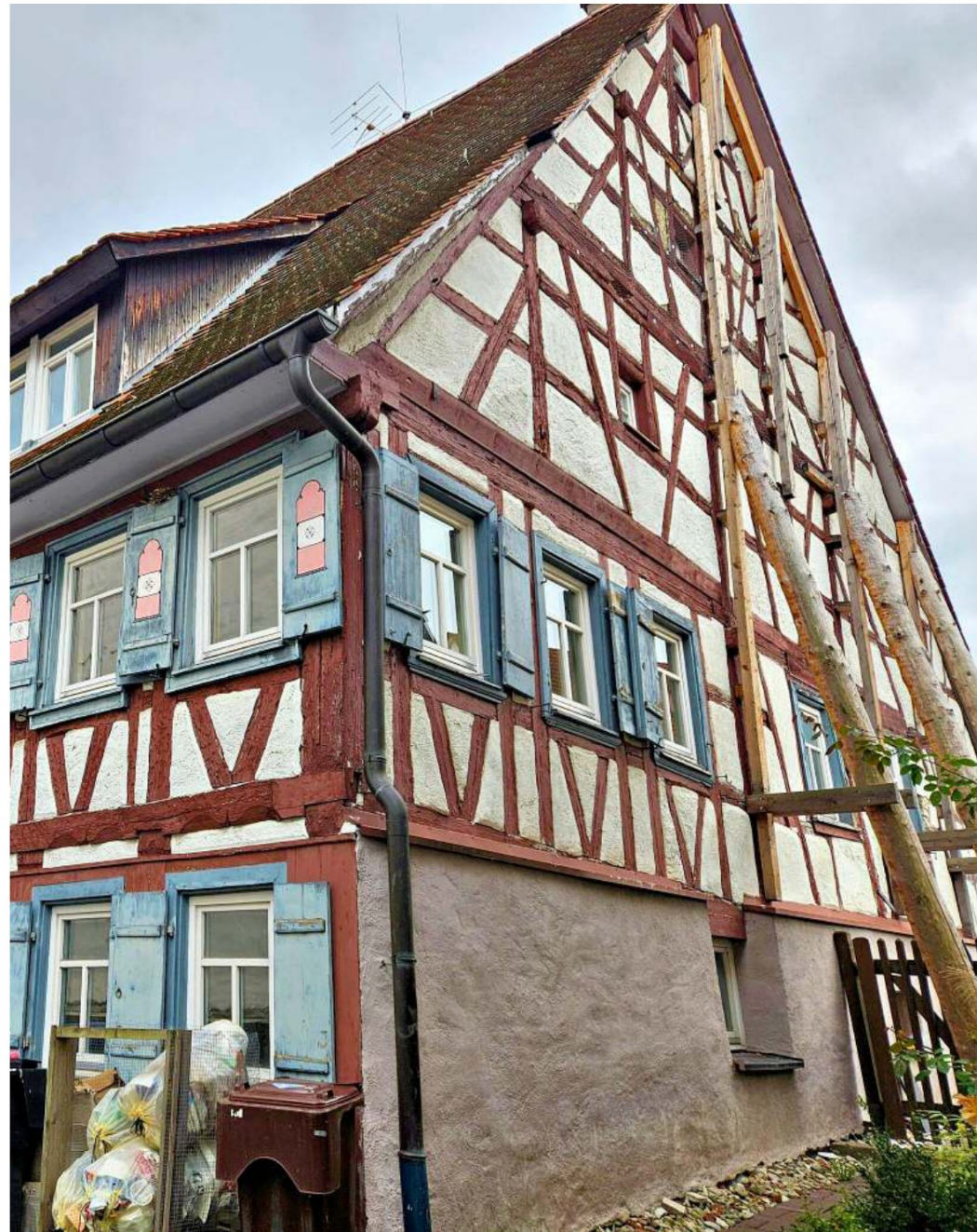
Sanierungsbedürftig und baufällig: Der Giebel des Wohnhauses, das an das Haus der Vereine grenzt, muss gestützt werden.
